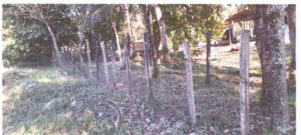
Foto 5: se observa el deterioro de la malla
