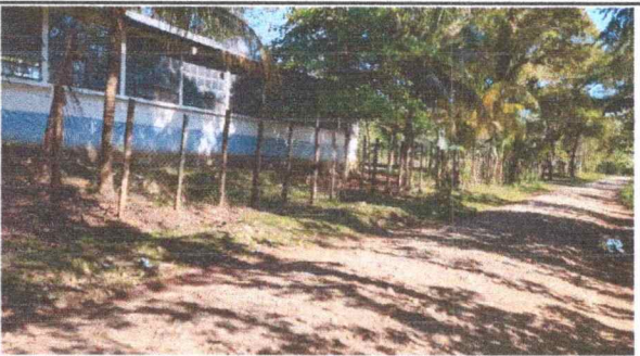
Foto 3: se observa el deterioro del cercado
